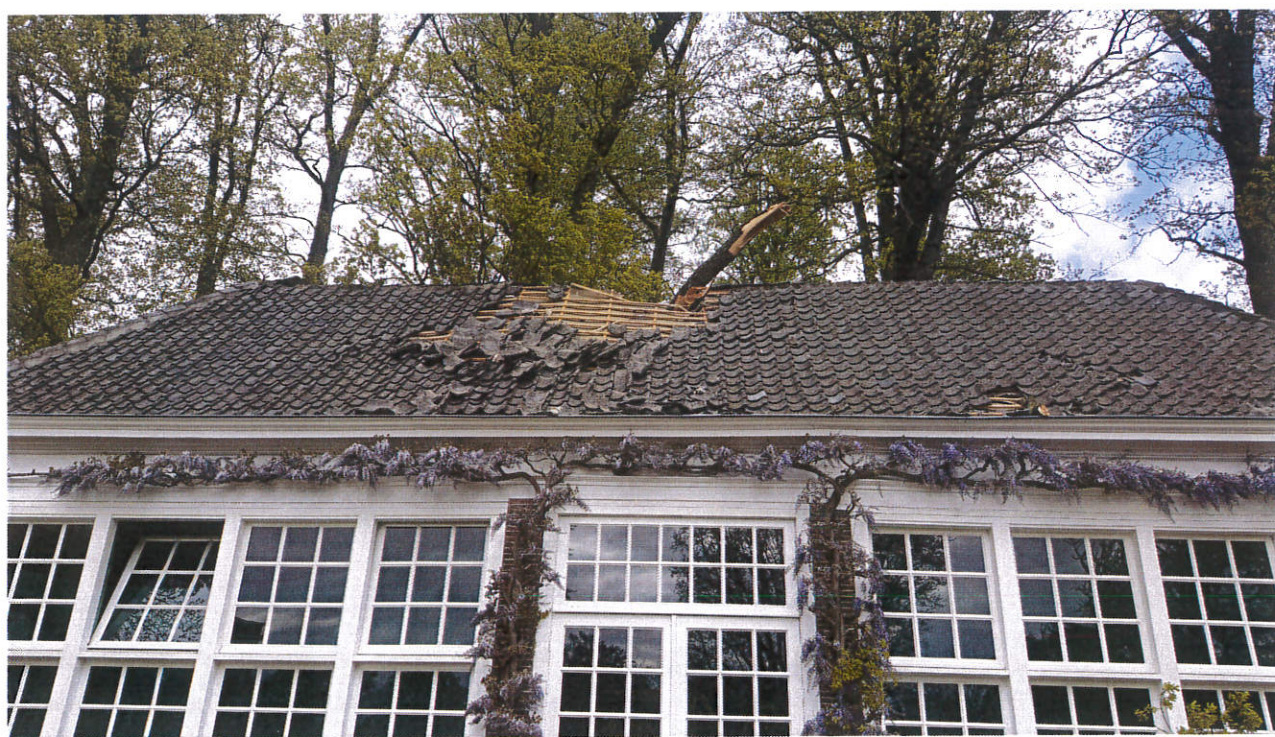
Stormschade aan de oranjerie door omvallende eik in voorjaar 2021
